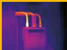
Mala conexión y daños internos
