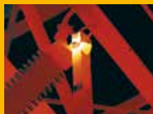
Conexión mal asegurada
