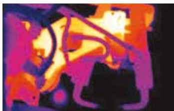
Punto caliente en robot de soldadura
