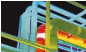
Daño en el aislamiento
