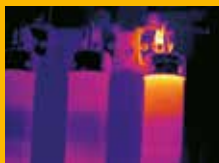
Daños internos en los fusibles
